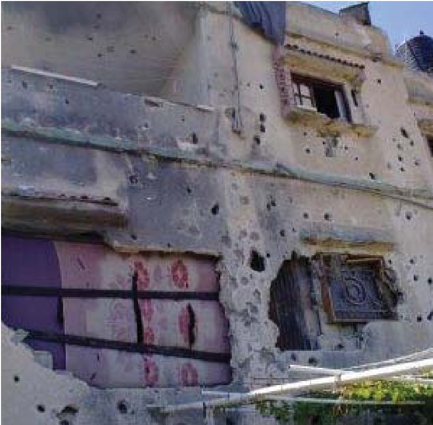
Damaged Exterior Wall in Beit Lahia | UUSC
